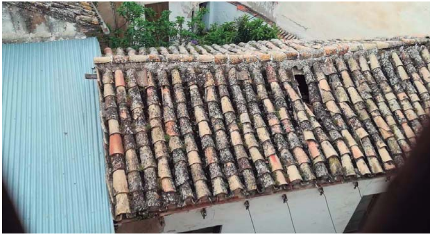
Estado de la cubierta del cuerpo secundario con protección volumétrica, parte desaparecida. (chapa)
